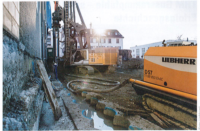
Perfektes Duo: mit dem Ramm- und Bohrgerät LRB 355 und der Kettenbetonpumpe THS 80 D-K setzt Hilti & Jehle in St. Gallen über 300 Pfähle
